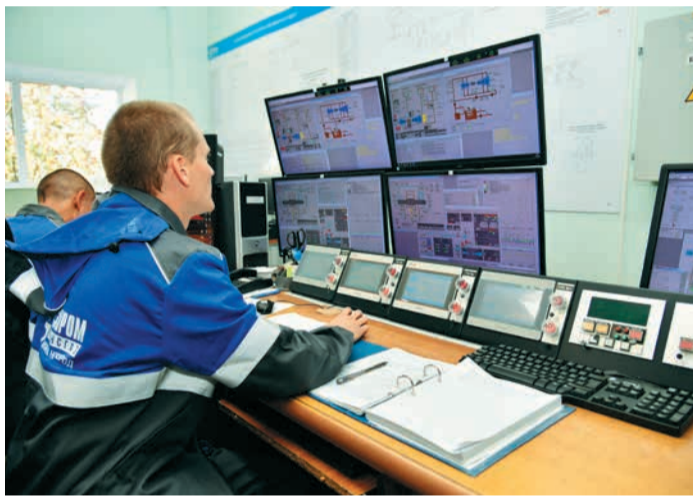
Щит управления компрессорного цеха
