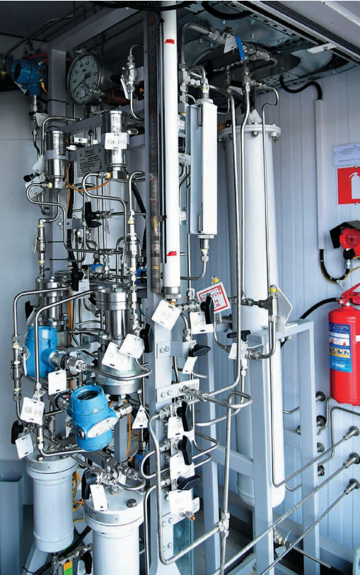
Блок одоризации на АГРС Новая Александровка
